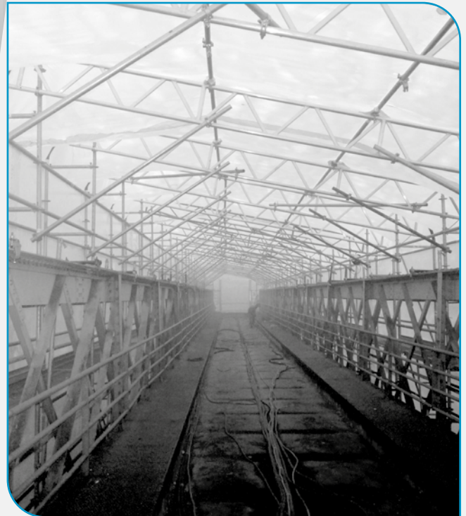
Confinement tablier de pont
